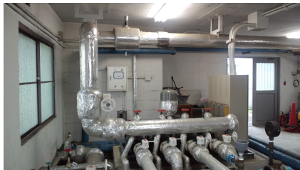
都内の大型分譲団地に取り付けられているNMRパイプテクター。写真上部中央の配管が膨らんだ部分がそれ＝住民提供
