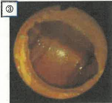
③402号室洗濯用水量器一次側 第一チーズ部手前側(13A)
