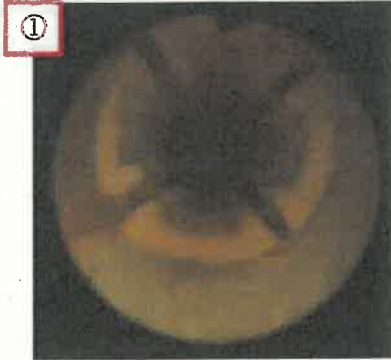
①402号室洗濯用水量器二次側 第一継手部手前側(13A)
