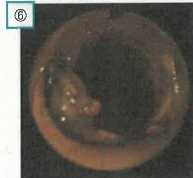
⑥402号室洗濯用水量器一次側 異径継手部(25A→20A)
