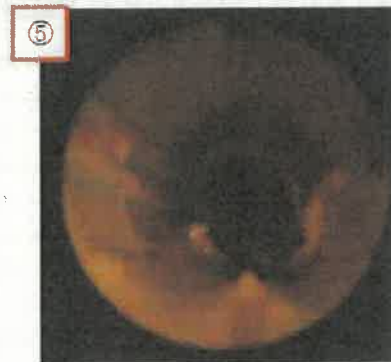
⑤402号室洗濯用水量器二次側 第三チーズ部手前側(25A)
