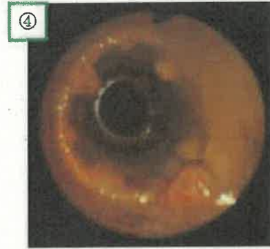
④402号室洗濯用水量器一次側 第二チーズ部手前側(25A)
